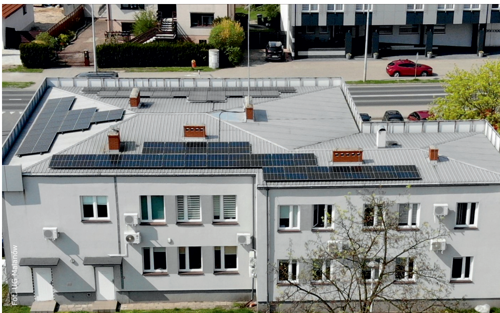
Panele fotowoltaiczne na budynku Urzędu Gminy w Malanowie
